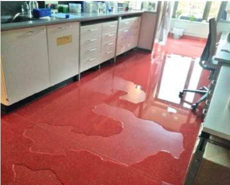
Abb. 1: Ansicht Laborraum nach Wasserschaden
